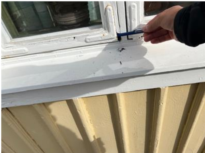
Pos 1. Rötskador förekommer i fönster.
