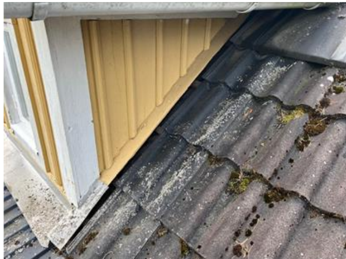
Pos 2. Otätheter mellan vattbrädor och takpannor.
