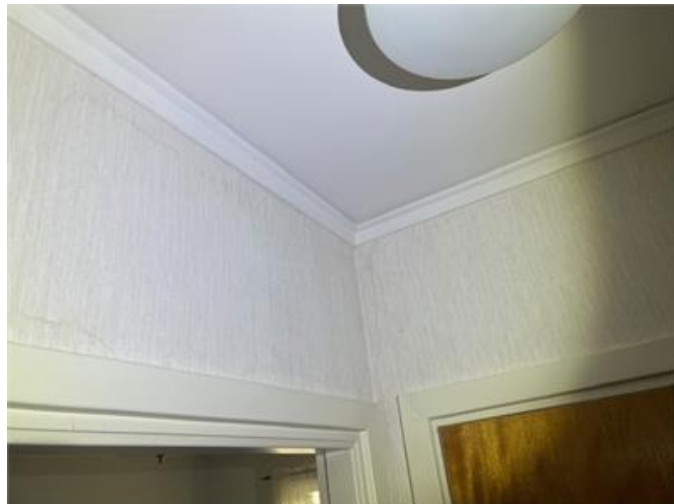
Pos 2. Fuktfläckar förekommer på vägg.
