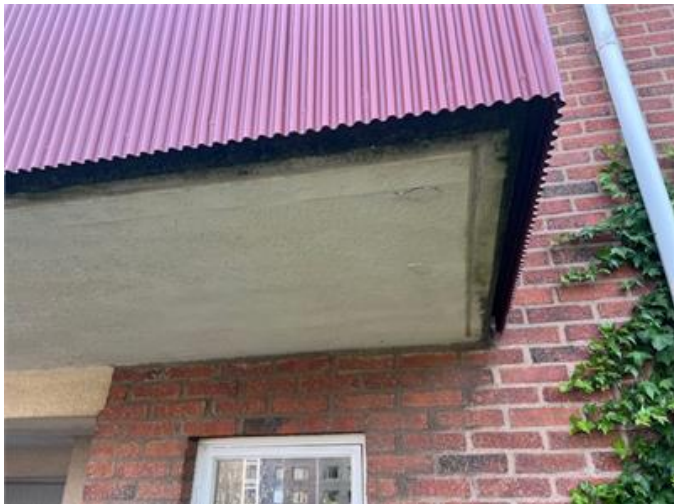
Pos 1. Mindre rostsprängningar förekommer i balkongplatta.
